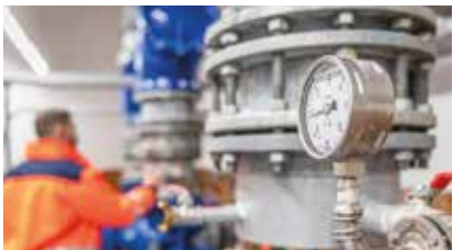
Ein Blick ins Pumpwerk am Hallenbad
