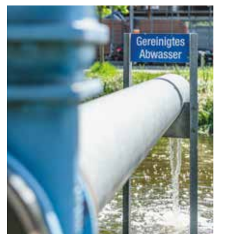
Etwa 24 Stunden dauert die Behandlung in der Kläranlage, dann ist das Abwasser gereinigt.
