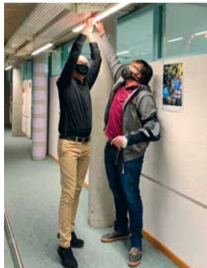
Bürgermeister Karl Langensteiner-Schönborn und Patrick Reißner vom Hochbauamt setzen eine neue LED-Deckenleuchte ein.
