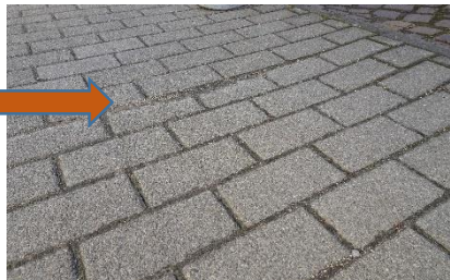
Unebener Gehweg, Absenkungen, Stolperstellen
