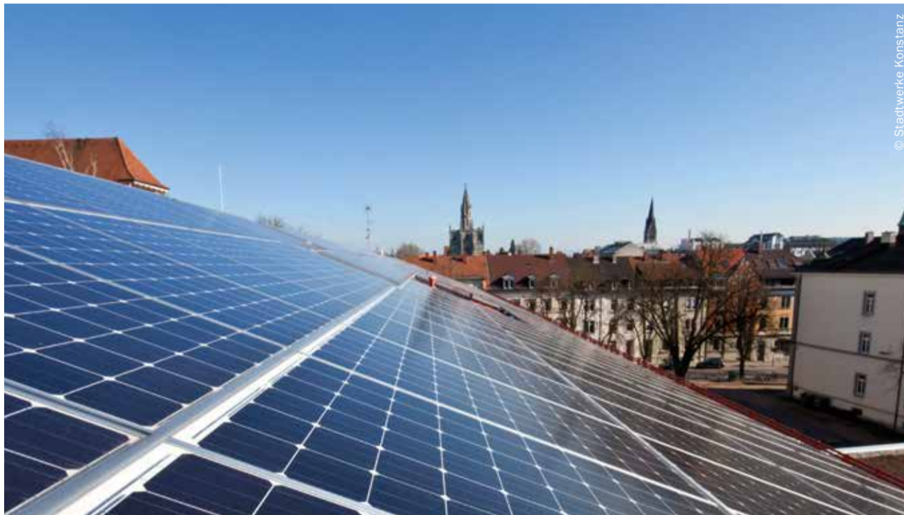
Die PV-Anlage auf dem Dach des Ellenrieder-Gymnasiums.
