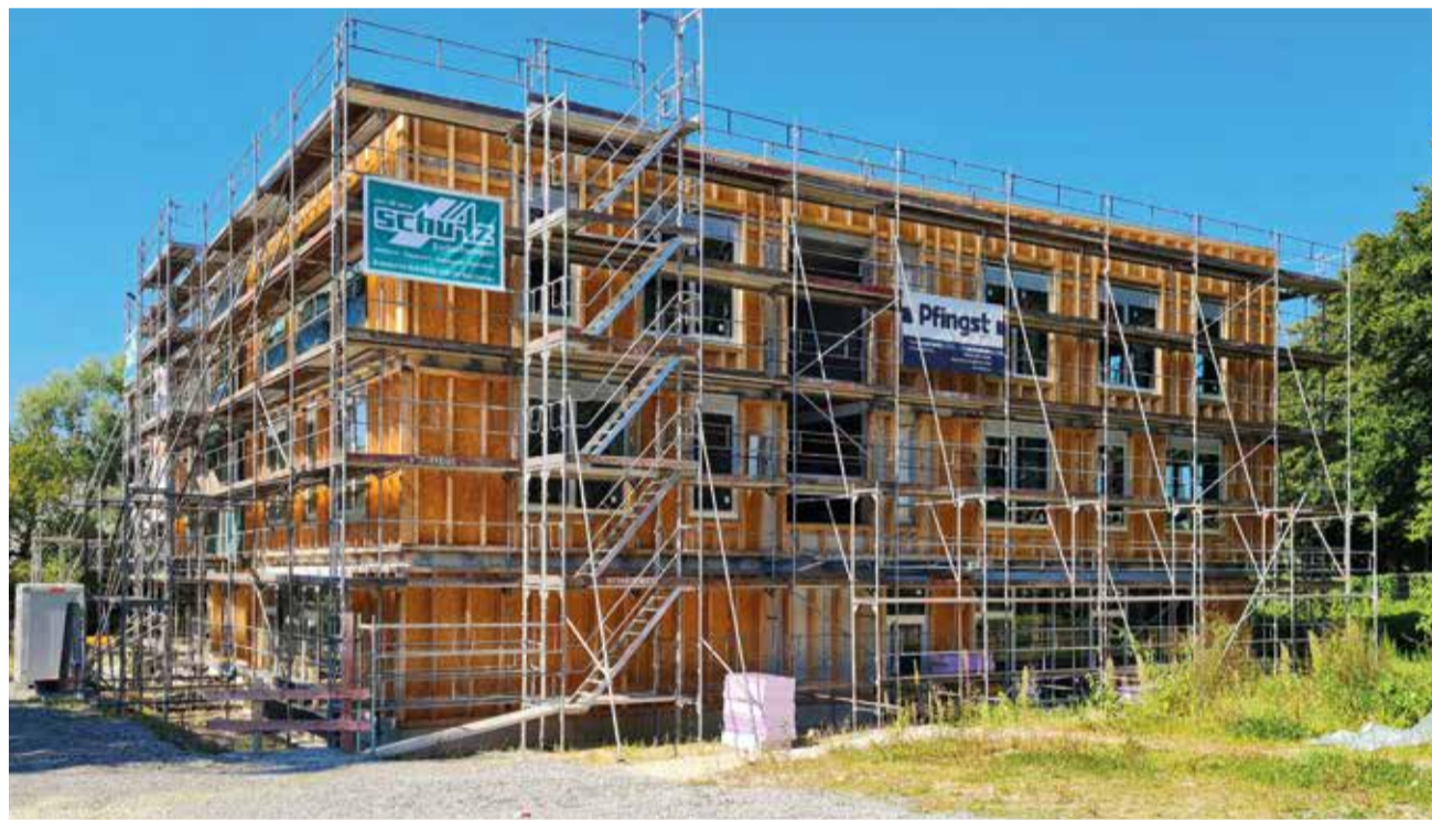
Die Kita Jungerhalde in Allmannsdorf wird in Holz-Hybridbauweise als Effizienzhaus 40 gebaut. Der Energieverbrauch liegt bei lediglich 40 Prozent des Wertes, der vom Gesetzgeber vorgegeben ist. Bezugfertig ist das Gebäude im Juni 2022.
