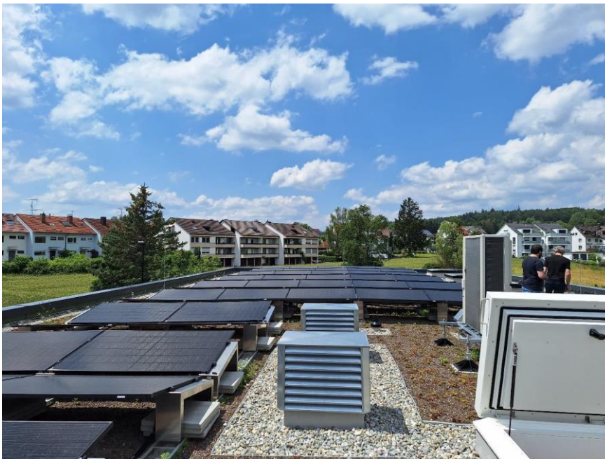
Abbildung 10: PV-Anlage auf dem Neubau des Feuerwehrgebäudes Dettingen
