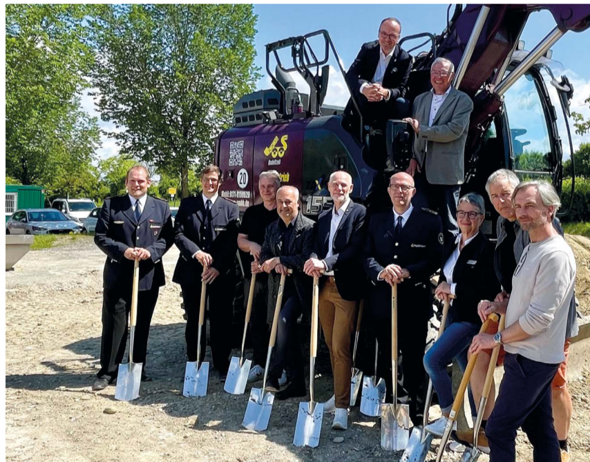
Spatenstich für das neue Feuerwehrhaus in Dingelsdorf. Der Neubau ist das zweite von insgesamt vier geplanten neuen Feuerwehrhäusern in Konstanz. Das zweigeschossige Gebäude wird in nachhaltiger Holzbauweise mit nachwachsenden Dämmmaterialien auf einer Betonbodenplatte erstellt. Fertig gestellt werden soll das Feuerwehrhaus bis zum dritten Quartal 2025.
