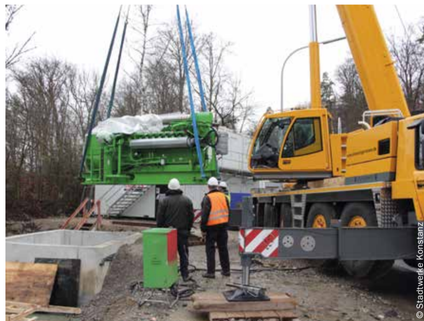
Die Stadtwerke Konstanz setzen beim Neubauprojekt am Pfeiferhölzle auf ein Nahwärmenetz (Aufnahme entstand vor Corona).
